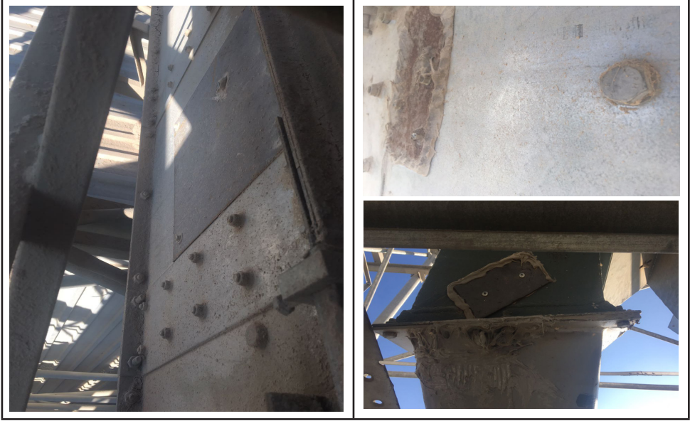
Şekil-3.37: Mevcut Konveyörlerde Deforme Olan Lokasyon Görüntüleri
